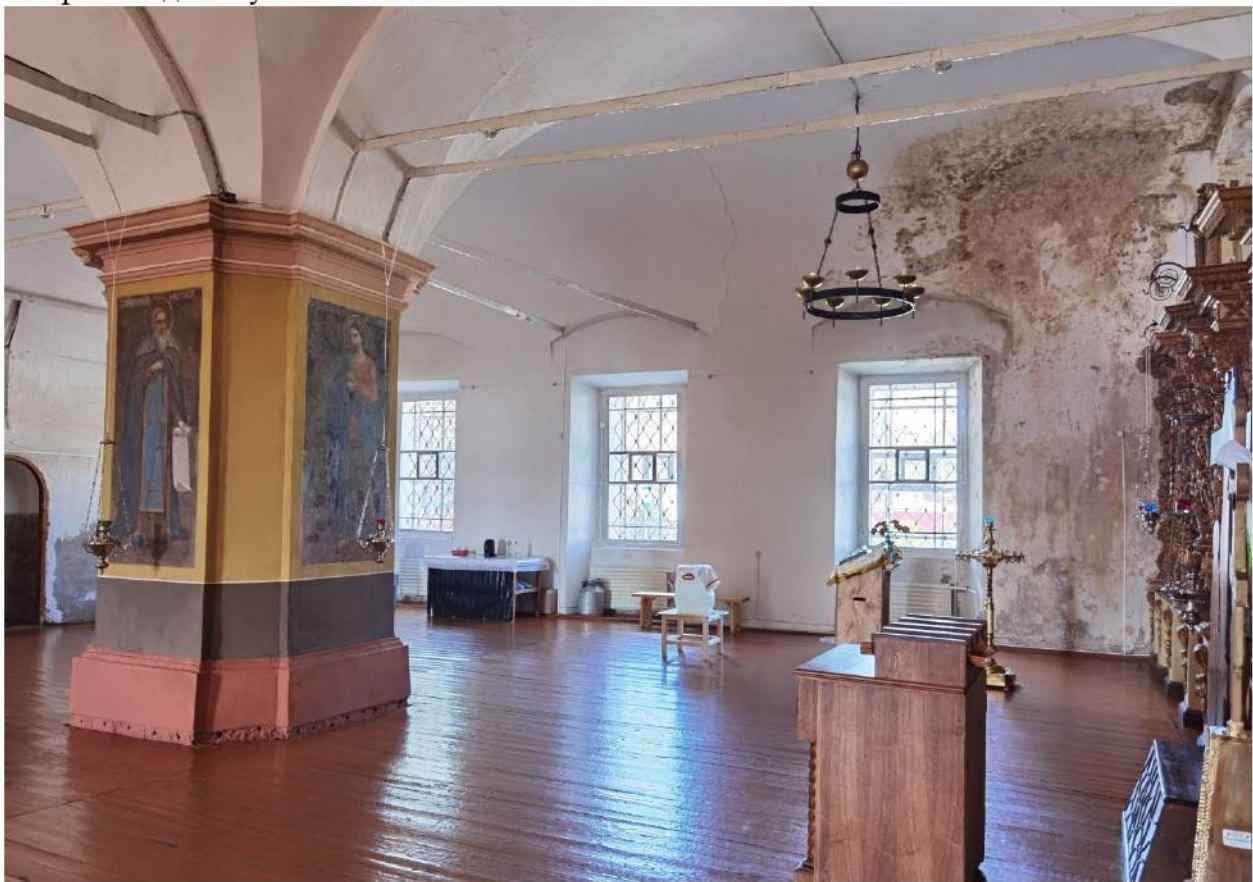
74. Костромская обл., г. Нерехта. Церковь Богоявления (Никольская). Трапезная. Окна северного фасада. Фото июль 2024 г.
