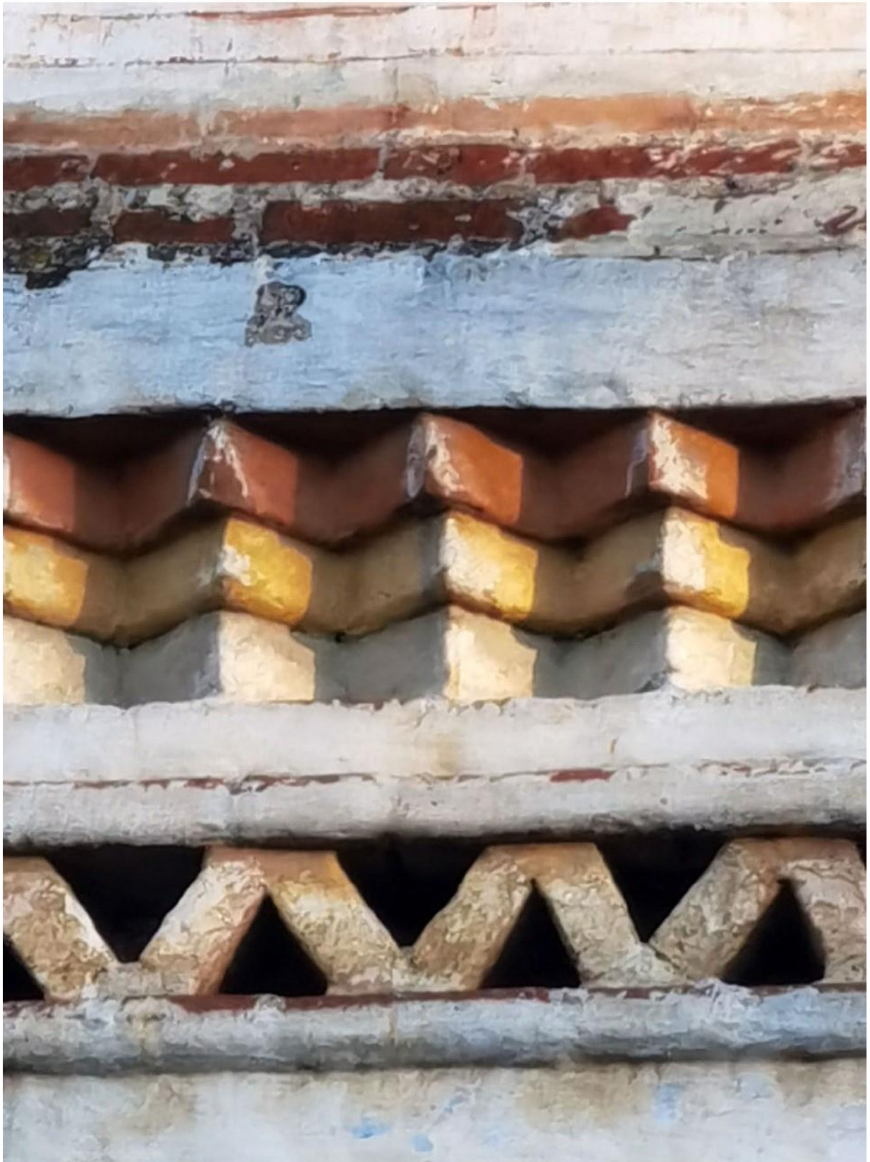
14. Костромская обл., г. Нерехта. Церковь Богоявления (Никольская). Северный фасад четверика. Окраска карниза четверика: пилю и бегунца.
