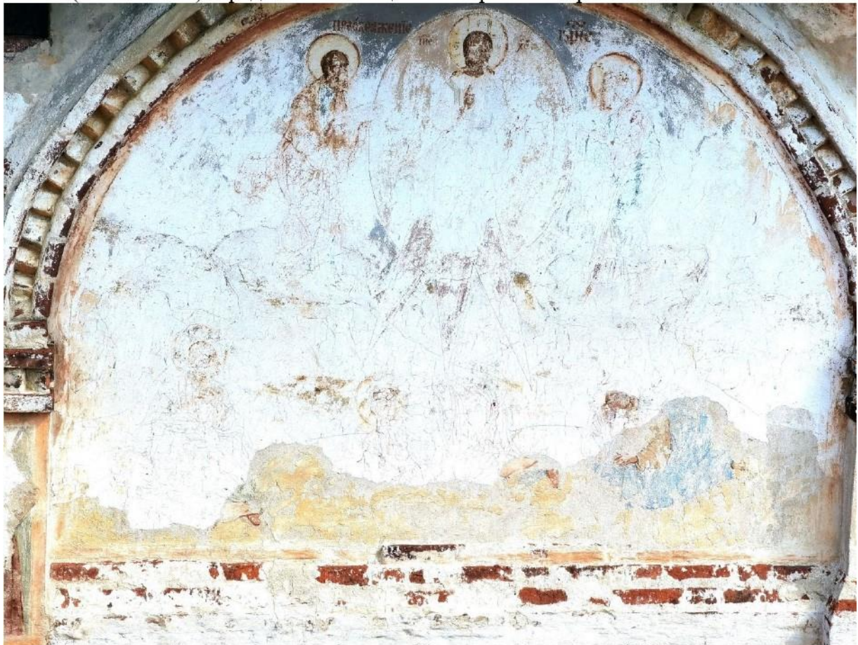
13. Костромская обл., г. Нерехта. Западный фасад четверика церкви Богоявления (Никольской). Правая композиция «Преображение».
