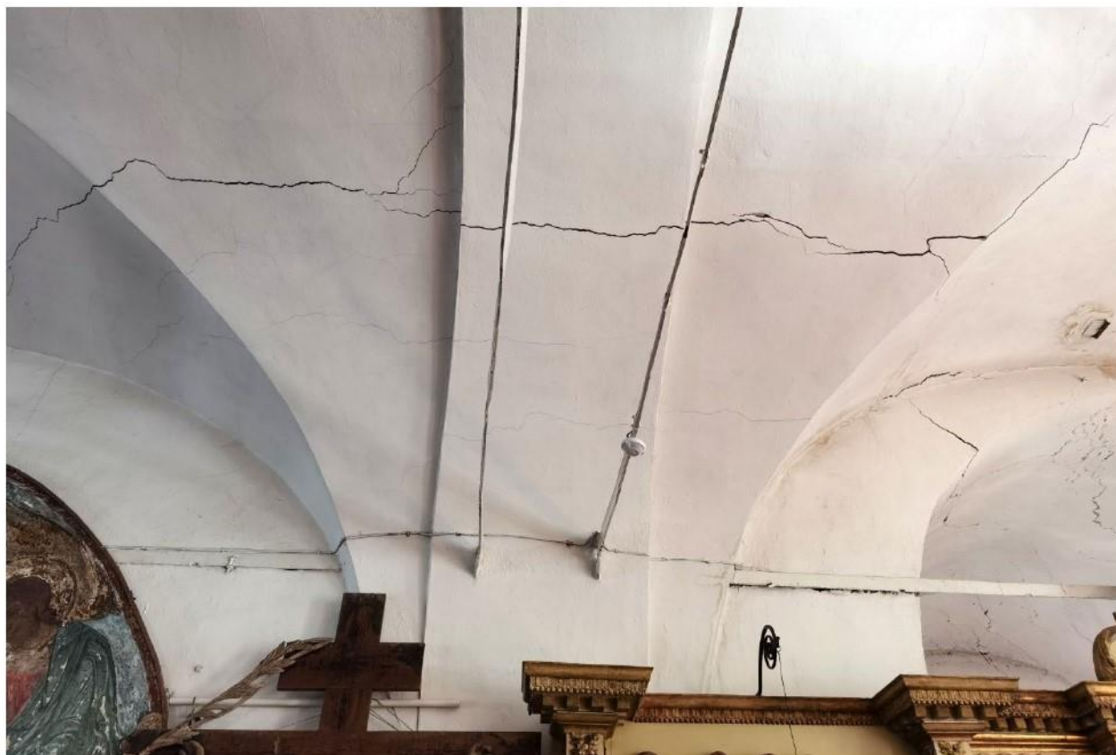
69. Костромская обл., г. Нерехта. Церковь Богоявления (Никольская). Трапезная. Своды с распалубками, арка и железные связи. Фото июль 2024 г.
