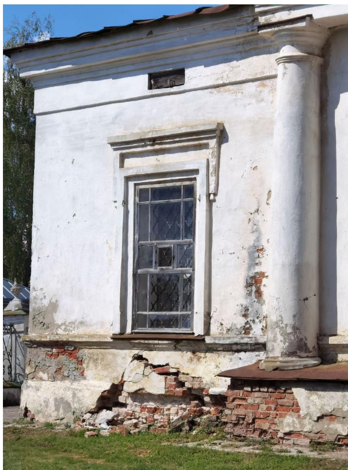
26. Костромская обл., г. Нерехта. Церковь Богоявления (Никольская). Южная палатка. Окно южного фасада. Фото июль 2024 г.
